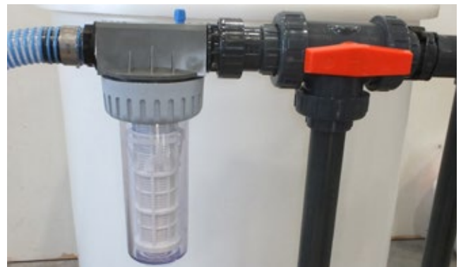
Filter och 3-vägs ventil
